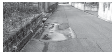
道路からの出水状況 水道施設課 ☎(63)7131
