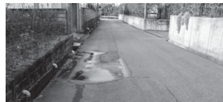
道路からの出水状況
