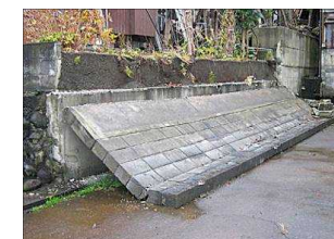
【ブロック塀の倒壊状況】
