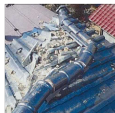
【屋根瓦の被災状況】
