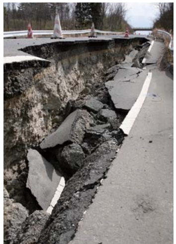
松塚地内の市道崩落
