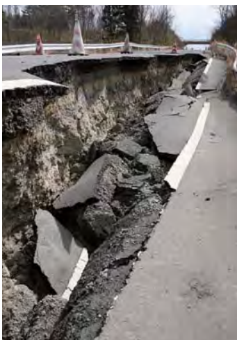
松塚地内の市道崩落
