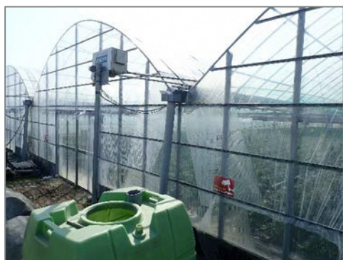
防犯カメラの設置
