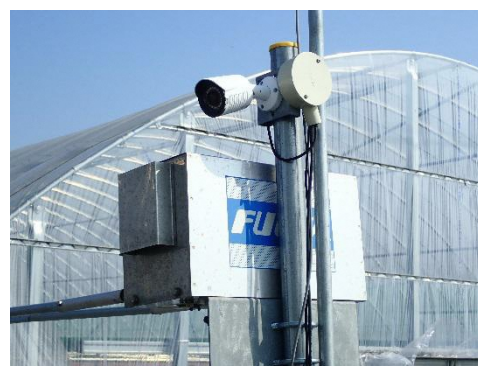
防犯カメラの設置
