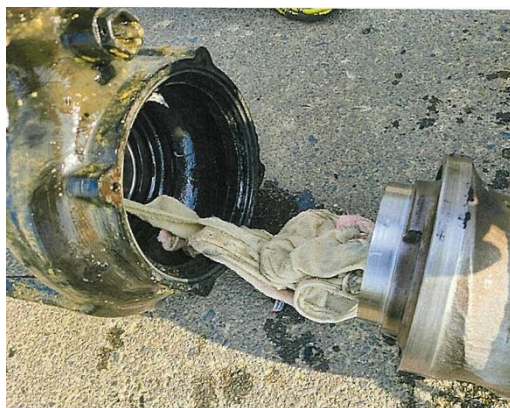
分解し内部確認したところ (フェイスタオルによる詰まり)
