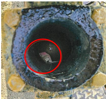
実際に詰まりが発生したポンプ (丸部分が異物)
