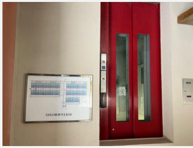
エレベーター(1,2,3,4,8号棟)
