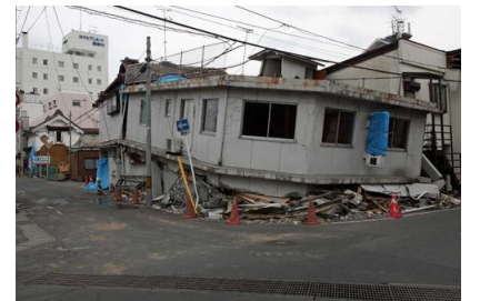
建物の被災状況（加治町地内）
