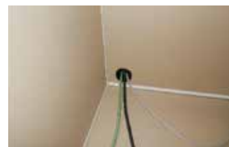
▲ケーブルを通すためのサービスホール
