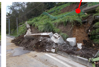
国道299号側面で土砂崩落数日間通行止め（熊木町地内）
