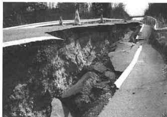
松塚地内の市道陥没
