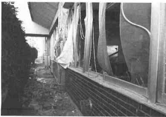
市役所庁舎各階の被災状況 (1階外側から撮影)
