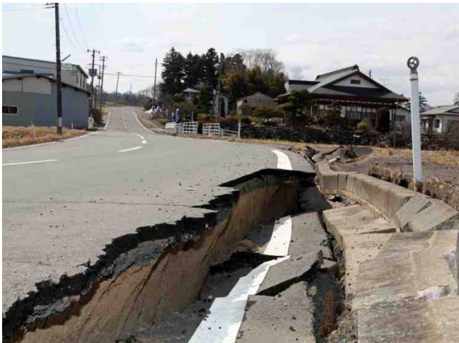
道路の被災状況（大久保地内）
