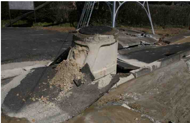
集落排水施設の被災状況（大久保地内）
