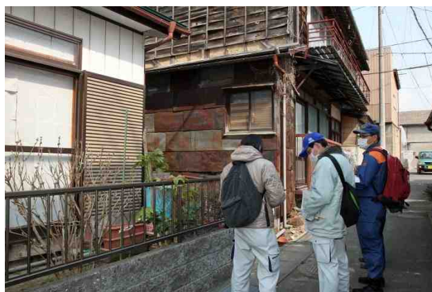
家屋被害調査
