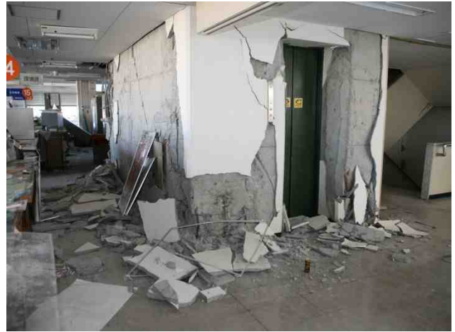
市役所庁舎の被災状況（2階）
