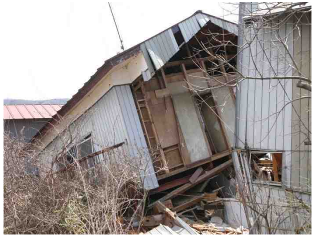
家屋の被災状況（岩瀬地内）
