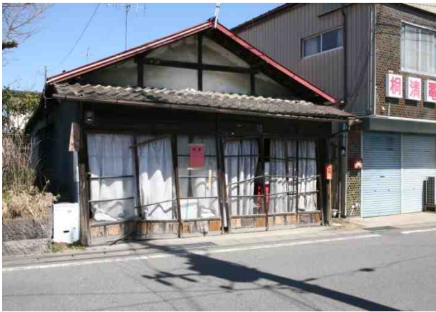
家屋の被災状況（旭町地内）
