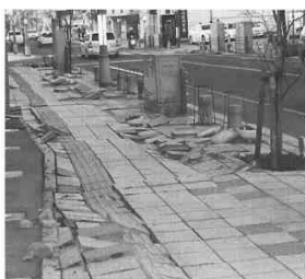
損壊した市総合福祉センター前の歩道
