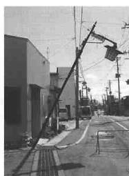
諏訪町地内の被害
