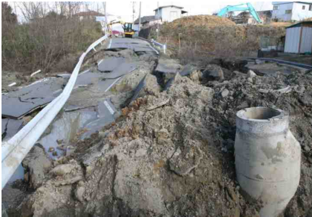
道路の被災状況（緑町地内）
