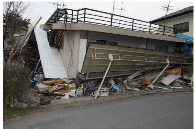
家屋の被災状況（森宿字向日向地内）
