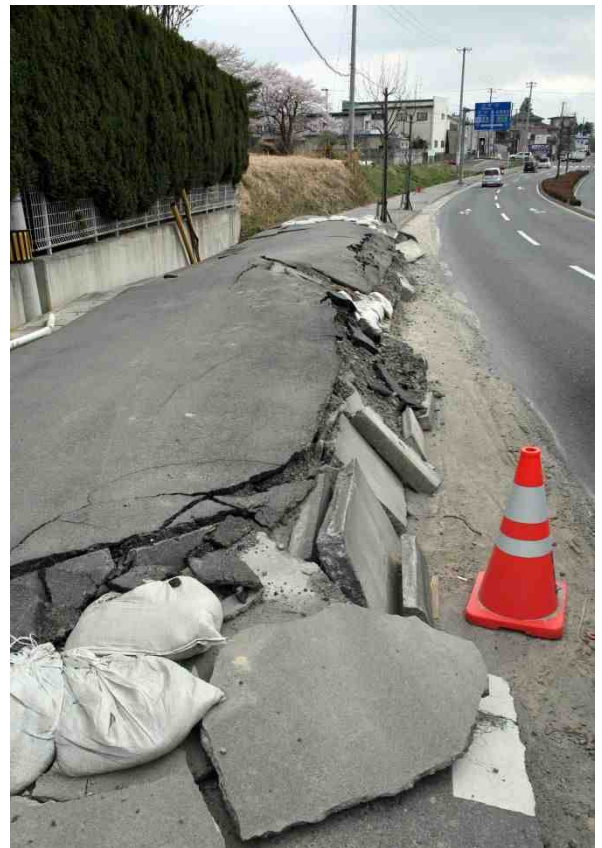
道路の被災状況（南上町地内）
