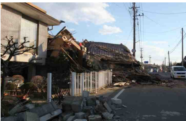
家屋の被災状況（南町地内）
