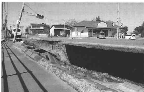
陥没した吉美根字土橋地内
