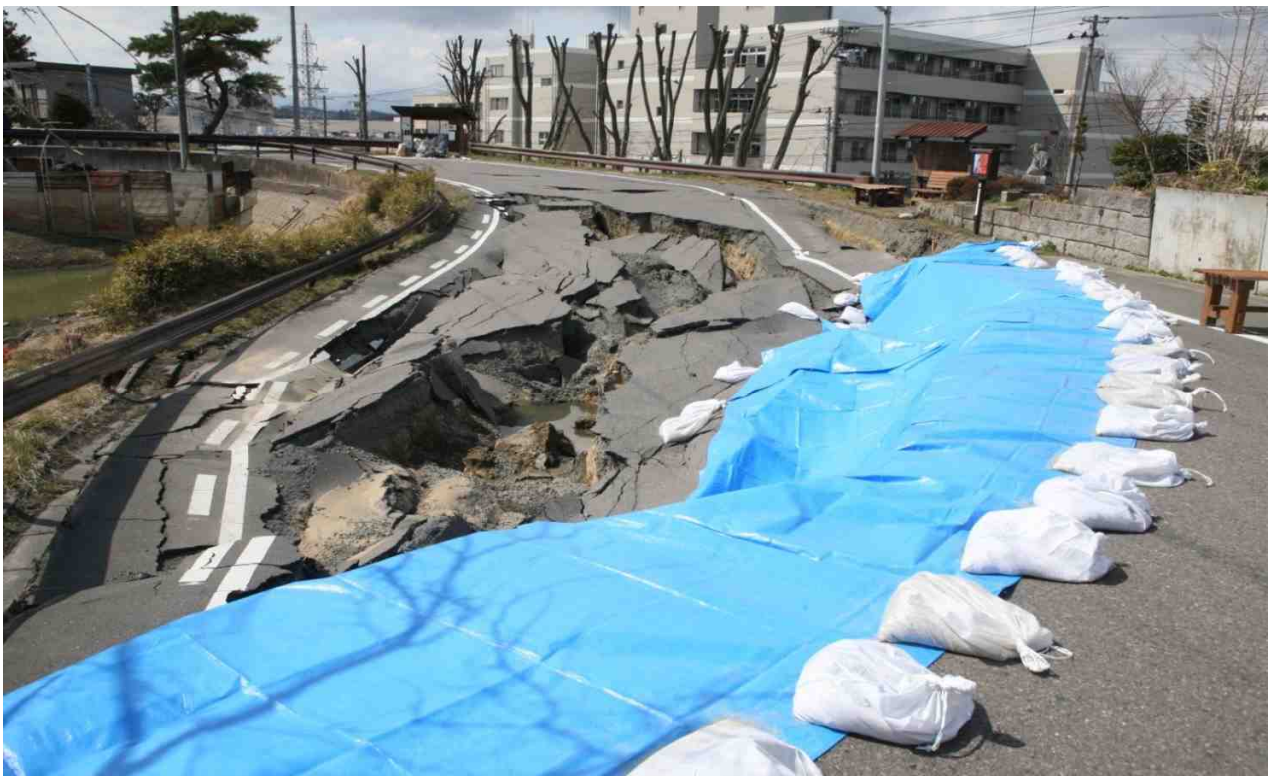
道路の被災状況（八幡山地内）
