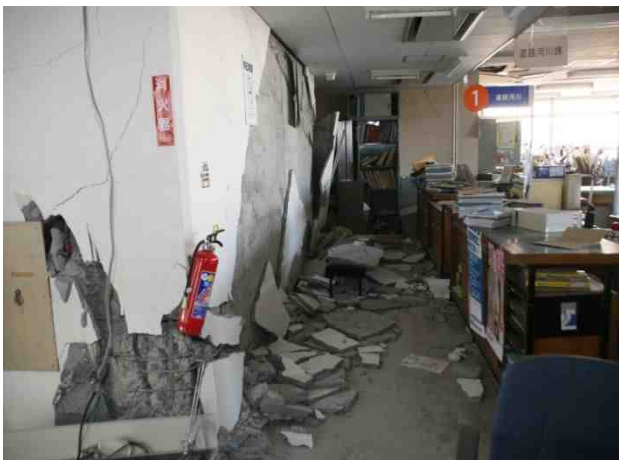
市役所庁舎の被災状況（2階）
