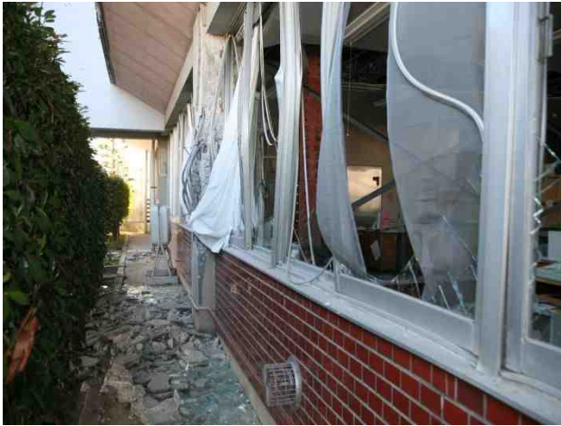
市役所庁舎の被災状況（1階）
