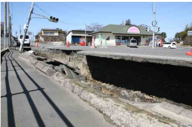
道路の被災状況（吉美根字土橋地内）
