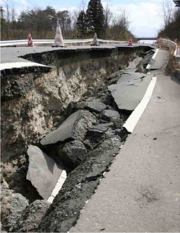
道路の被災状況（松塚地内）
