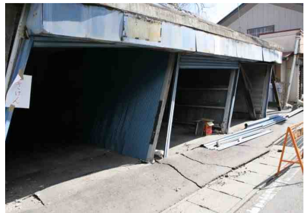
建物の被災状況（諏訪町地内）
