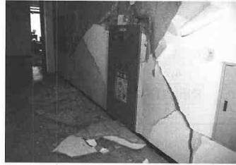
市役所庁舎各階の被災状況 (3階)
