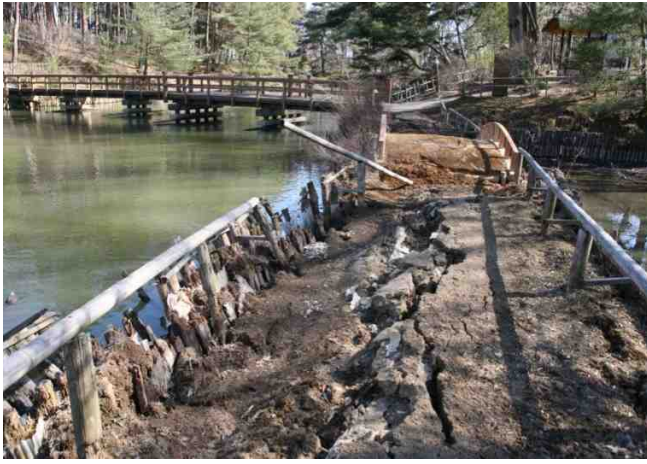
公共施設の被災状況（須賀川牡丹園内）
