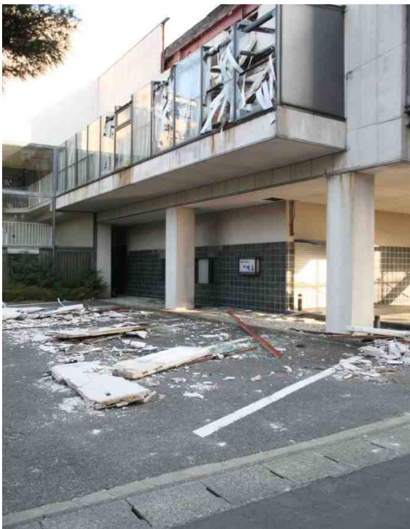
建物の被災状況（東町地内）
