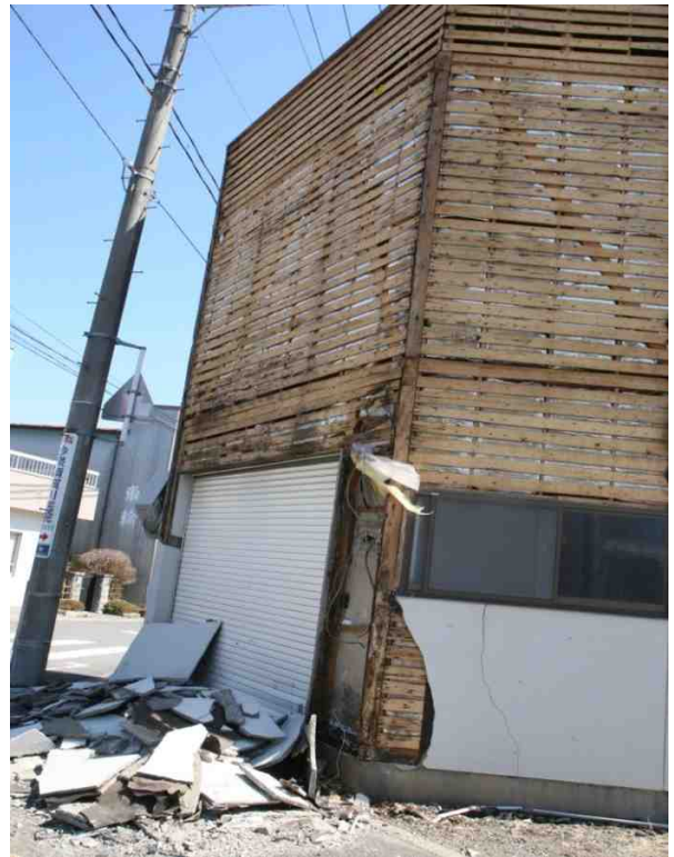
家屋の被災状況（旭町地内）
