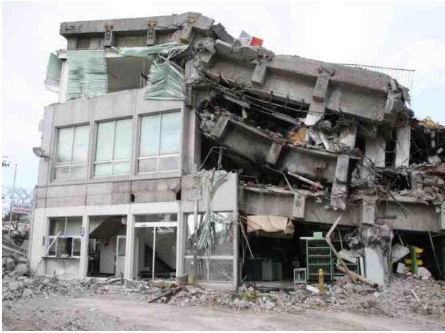
建物の被災状況（林精器）
