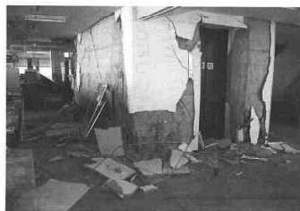
市役所庁舎各階の被災状況 (2階)
