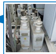
キュービクル キュービクル内部
