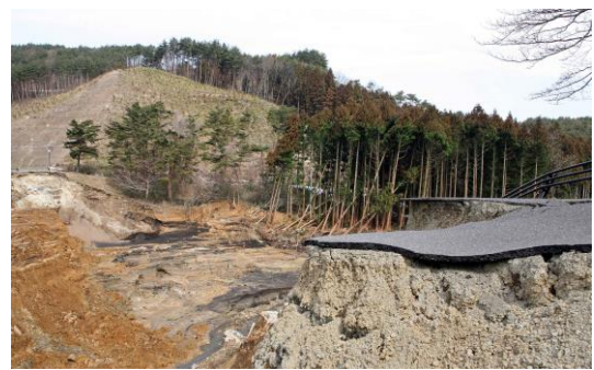
【震災当時：決壊した藤沼ダム】
