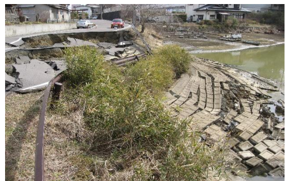
【被害状況(大黒池えん堤)】
