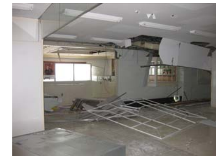
構造躯体等損傷 （総合福祉センター）
