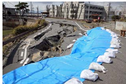
道路崩落（大黒池沿い）
