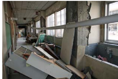
構造躯体損傷（第一小学校）
