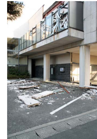
家屋破損（東町地内）
