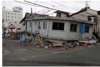
家屋倒壊（加治町地内）
