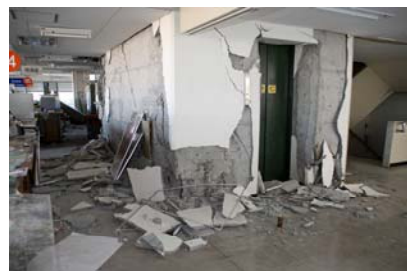
構造躯体等損傷 （本庁舎）
