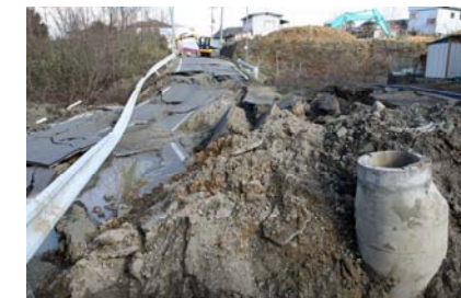
道路崩落（緑町地内）
